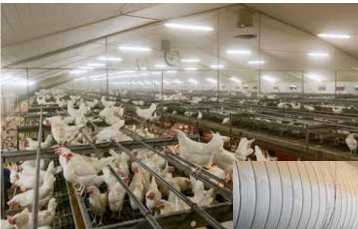
Luften fra varmeveksleren blæses ind midt i stalden og fordeles med en serie af ventilatorer
