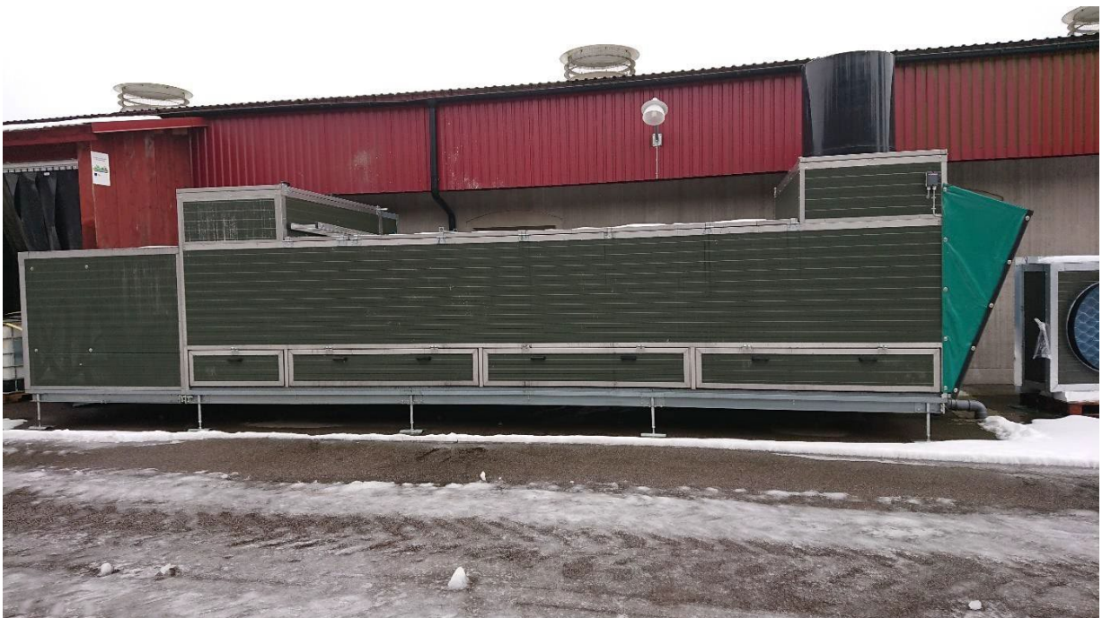
Bilag 7. Rekuperative varmevekslere med tilhørende ventilatorer
